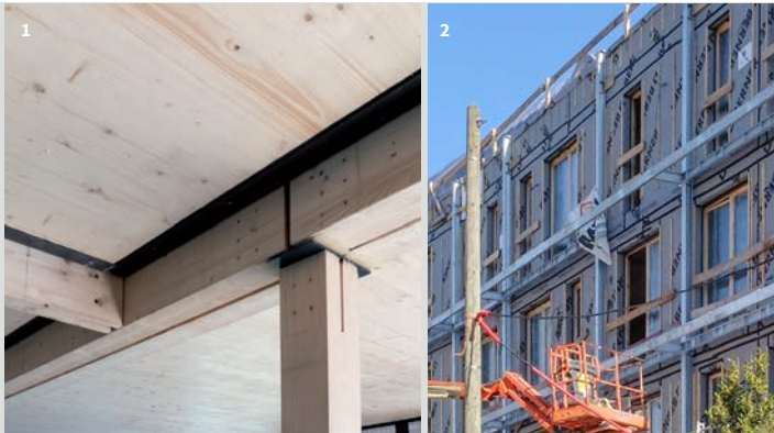
1_L'association du CLT et des profils HEA permet de diminuer l'épaisseur des planchers 2_ Les balcons sont désolidarisés et composés d'une structure métallique et d'un platelage bois
